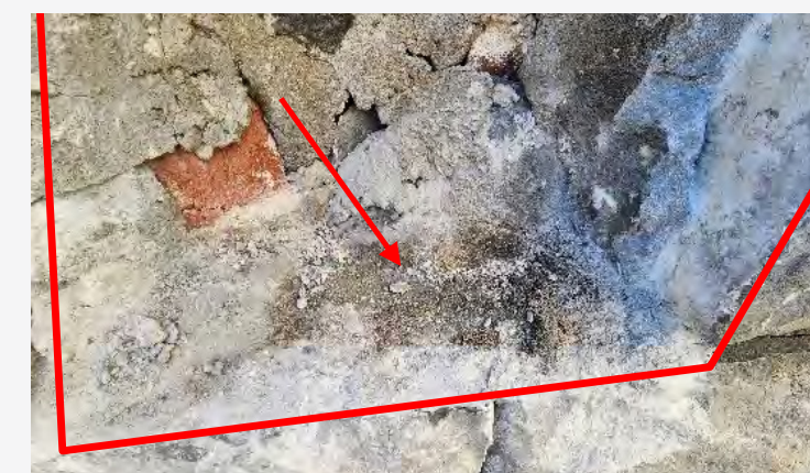
Légères traces d'humidité dans le mortier au bas de la pierre (source: Idem)
