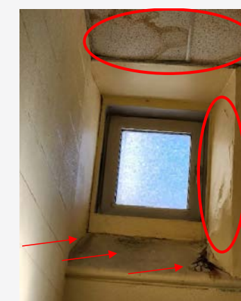
Vue intérieure d'une fenêtre, avec signes d'infiltrations à l'appui de fenêtre, au jambage et au plafond (source: Idem)
