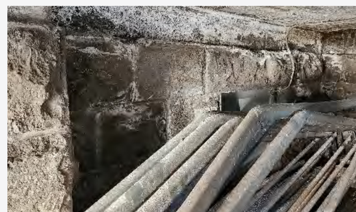
Efflorescence sous la dalle de parvis (source: Idem)
