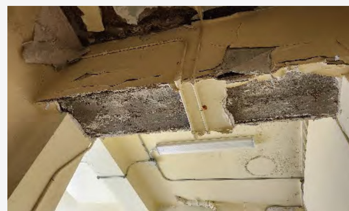
Dalle et poutre de béton endommagées par les infiltrations, au niveau de l'entrée avant (source: Idem)
