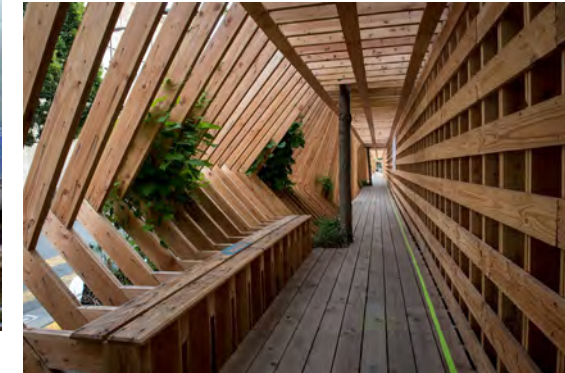
Installation temporaire pour circulation piétonne dans un chantier, Nantes, France © Atelier Vecteur
