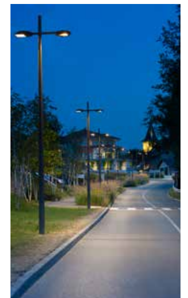
Fig. 173. Éclairage public (Source: SDEM50)
