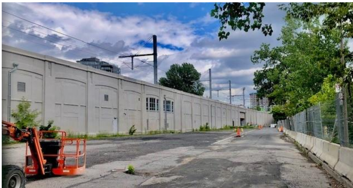
Face sud-ouest du bâtiment-pont ferroviaire illustrant les ouvertures obstruées en 1995 et, au centre, les fenêtres installées récemment par CDPQ Infra (bâtiment 6, future station Griffintown) source : PSC
