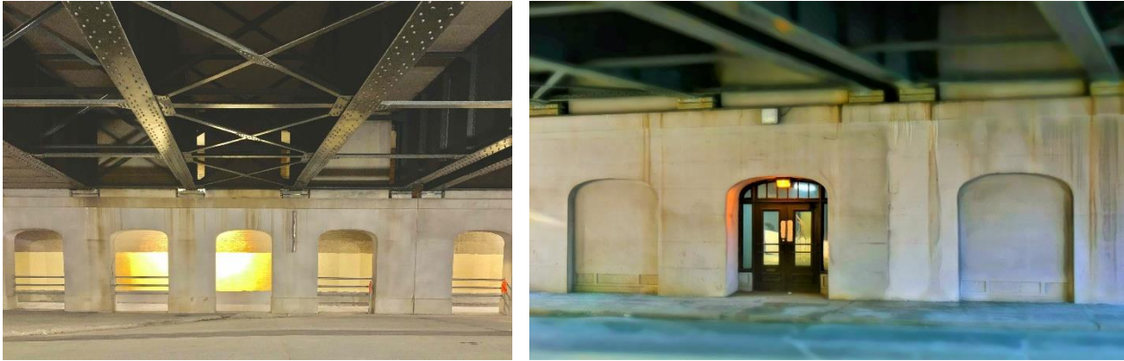
État des viaducs après la remise en état de la maçonnerie et de la structure d'acier par CDPQ Infra source : psc
