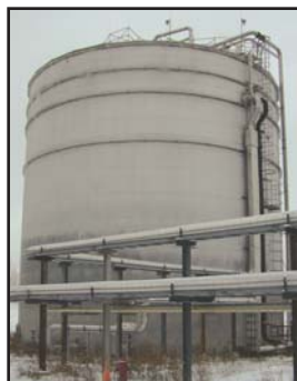
Digesteur anaérobie de la Ville de Toronto Photo : SOLINOV
