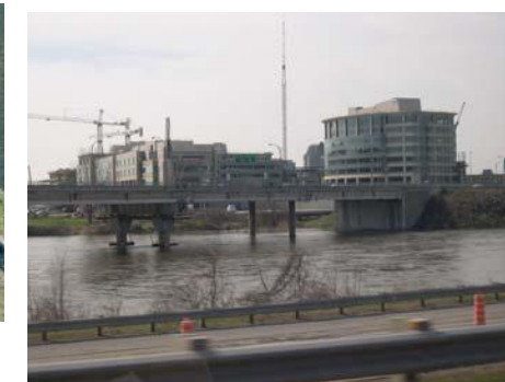
Campus Bell en construction sur la pointe nord de l'Île-des-Sœurs à partir de l'autoroute Bonaventure
