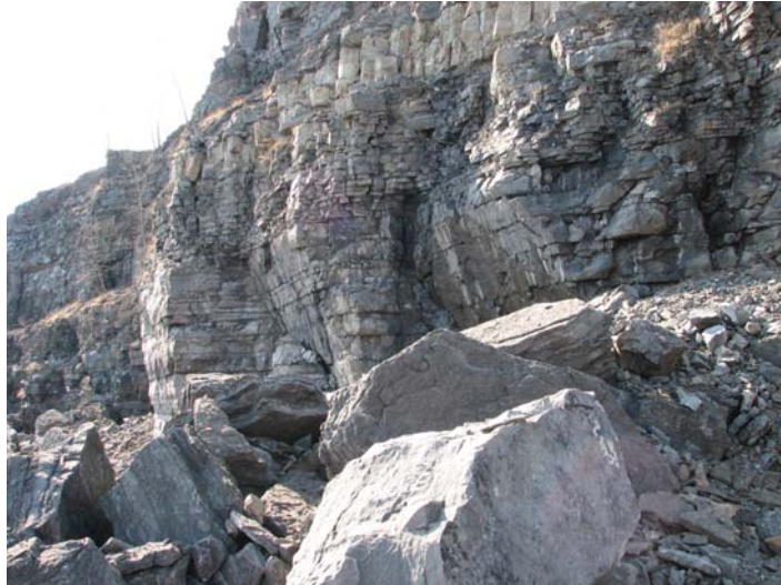
Photo 3 : Vue rapprochée illustrant la grande fissuration des parois.
